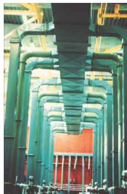
Photo 3. Les installations de ventilation ont été soulignées pour mettre en valeur les lignes verticales et la forme de voûte. Des contrastes de couleur ont été recherchés avec les structures de la toiture (en jaune) et les murs (rouge) accentuant l'impression de légèreté de l'ensemble.
